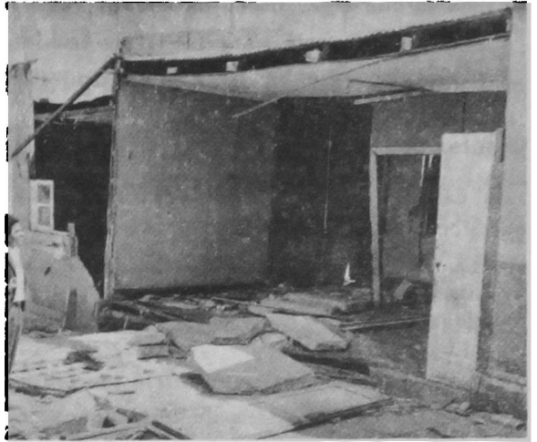
Fig. 6. Vivienda de hormigón y madera completamente destruida.
