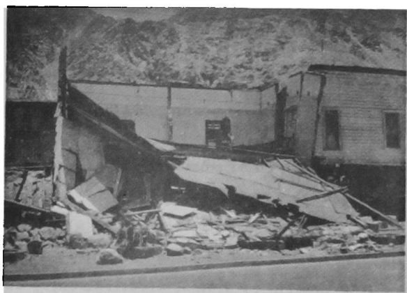
Fig. 5. Destrucción total en casa de hormigón pobre con madera. Tocopilla.
